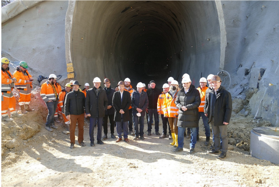
Bildunterschrift: Vertreterinnen und Vertreter des Zweckverbands Hermann-Hesse-Bahn, des Landratsamts, der Baufirma und aus der Politik am 08.03.2022 beim Tuneldurchstich. Bildquelle: Janina Müsle, Landratsamt Calw.
